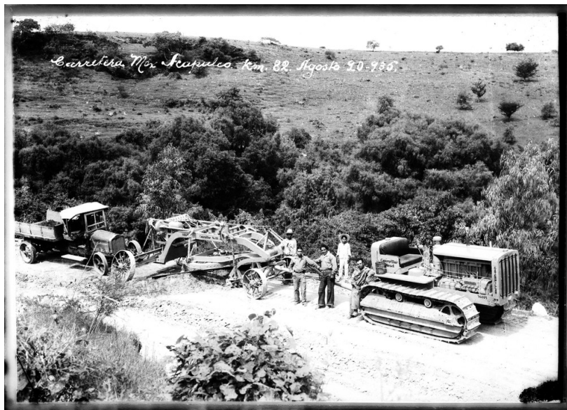
Trabajadores de la carretera México-Acapulco 1935. Reproducción Autorizada por el Instituto Nacional de Antropología e Historia.
